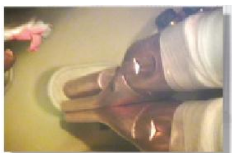
显示油中接头及接线片处的清晰图像
